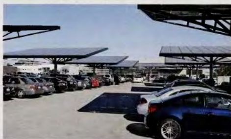
Φωτοβολταϊκά συστήματα σε στέγαστρο του πάρκινγκ του νοσοκομείου.
